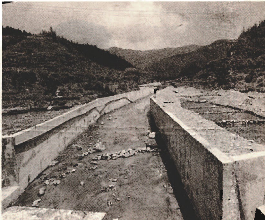
蘭嶼的溪流並沒有氾濫的現象，但當地地方政府仍多興建了水泥防洪道，反而加速河流生態的改變。圖梁皆得提供
